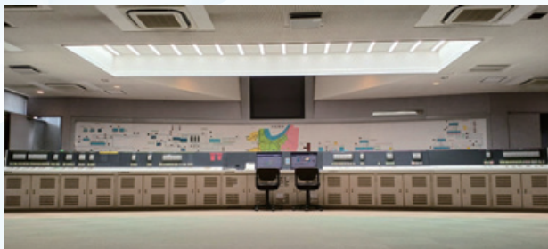
吐師受水場 中央監視室（京都府木津川市）
